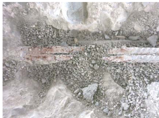
Abb.1: Infolge Chloridkorrosion vollständig durchkorrodierte Bewehrung in einer Tiefgaragen- decke.
