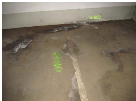
Abb.5: Ränder von Pfützen mit Salzablagernungen.
