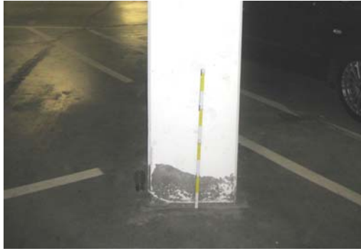
Abb.6: Ablätterungen des Anstrichs an einem Stützenfuß.
